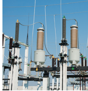
負荷遮断試験や開閉器の試験が可能
